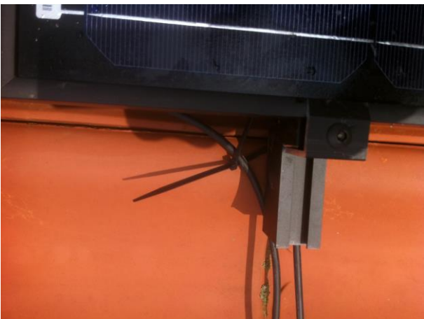
kabler fra inverter fastholdt på celler med strips
