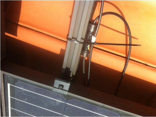
Ophæng af kabler under celler. (kun denne har fået en strips)
